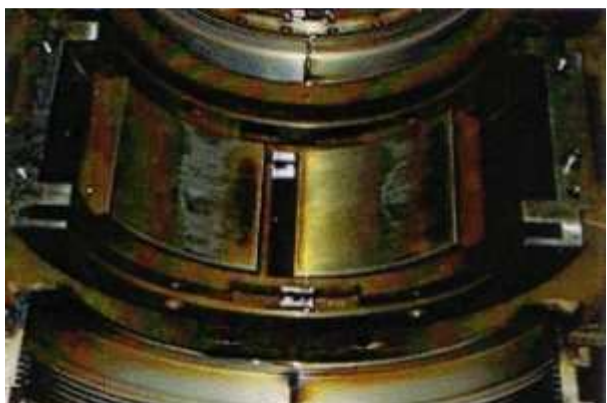
Рис. 1. Пример образования лакового слоя на внутренних поверхностях оборудования. Фотография подвижных частей турбины
