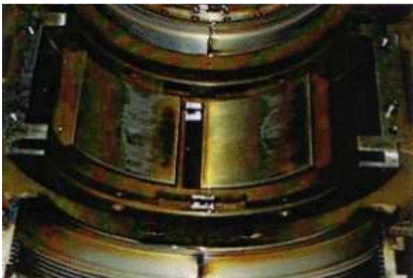
Рис. 1. Пример образования лакового слоя на внутренних поверхностях оборудования. Фотография подвижных частей турбины
